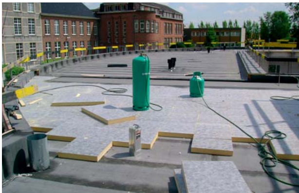
IKO enertherm BGF gekleefd met IKO pro PU lijm op bitumen onderlaag.
